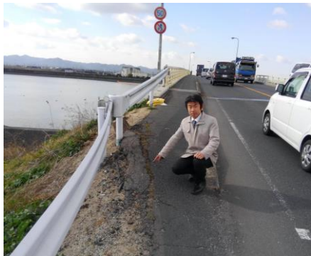
道路のひびは拡幅時に直します
